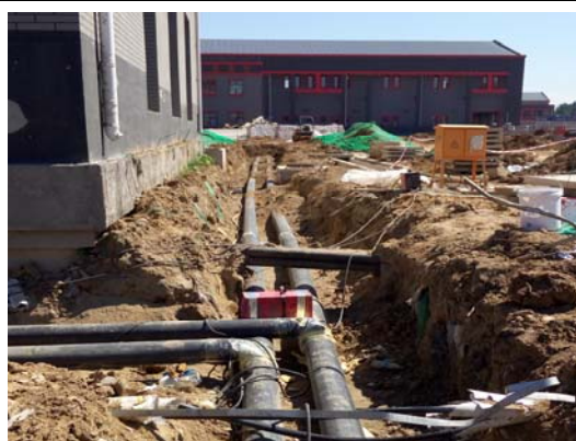
管线施工未苫盖（2016.9）
